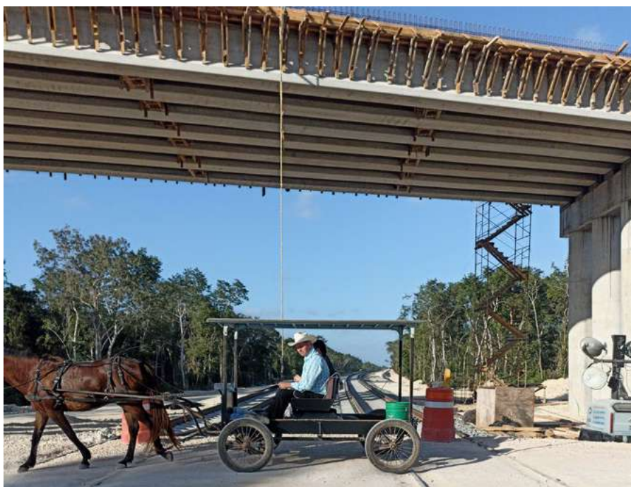
Figura 2. Puente en construcción y paso inferior vehicular en la estación Bacalar (Eliás Fonseca, 2024).
